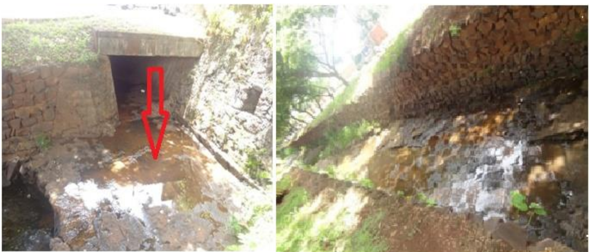
Figura 11. Ponto 01 - Nascente canalizada e percurso de sua vazante. (Imagens: OLIVEIRA, R. A.N.).
