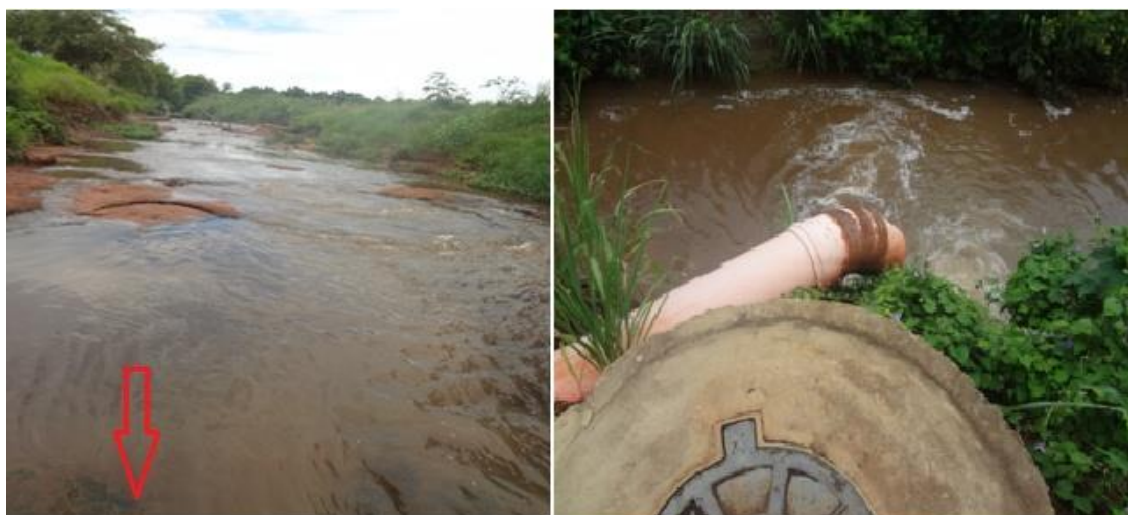
Figura 13. Ponto 03 – Junção de um braço do córrego com a água tratada da Estação de Tratamento de Esgoto Guaxinim e o cano de despejo do esgoto. (Imagens: OLIVEIRA, R. A.N.).
